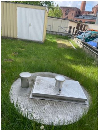
Brunnen – Notwasser- versorgung Stadtzentrum
